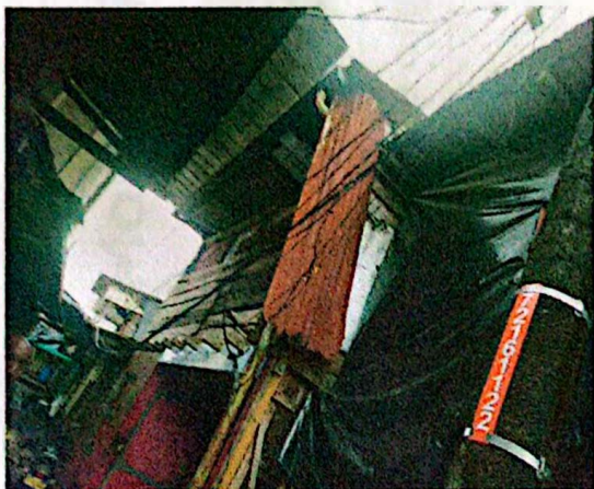
Conexiones irregulares de energía en Zona Humanitaria. Barrio La Playita. Fuente: Plataforma Cívica Marea Digital
