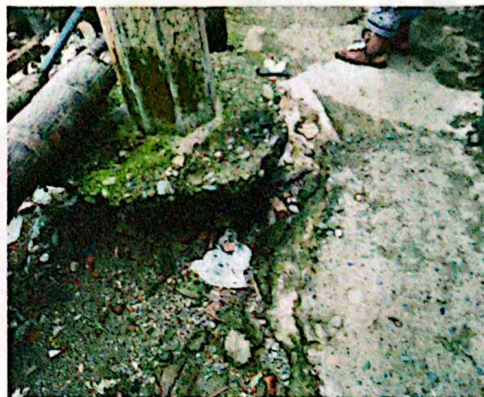
Riesgo de caída de poste en Zona Humanitaria. Barrio La Playita. Fuente: Plataforma Cívica Marea Digital
